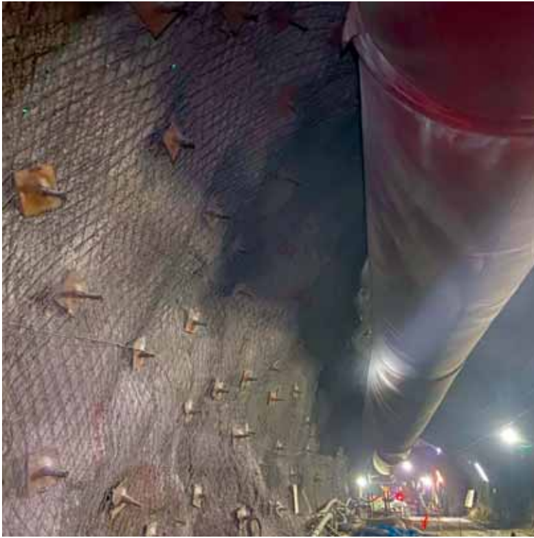
❖ Sistema de fortificación que asegura el control y estabilidad al interior mina.
